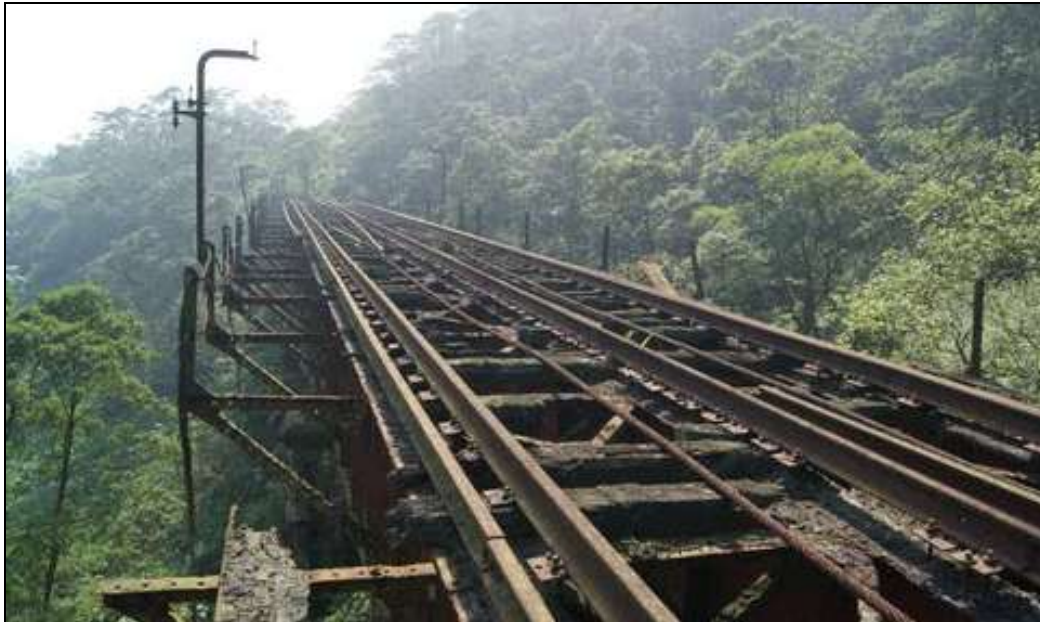
Foto 7.8 – Aspecto do estado de conservação do viaduto 12 da antiga Ferrovia São Paulo Railway
